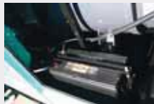
Cables de batería forrados
